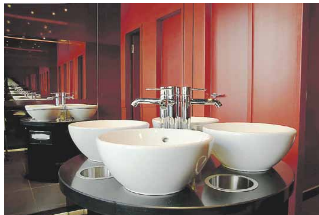
Die Raumgestaltung einer charismatischen Wellness- und Badausstattung einer Hotelanlage vereint Funktionalität, Ambiente und Wohlfühl. Mit Quarzcomposite, abgerundeten Formen und dem Spiel mit Farbe und Licht werden diese Eindrücke erzielt (Foto: SPEICHERWERKSTATT)
